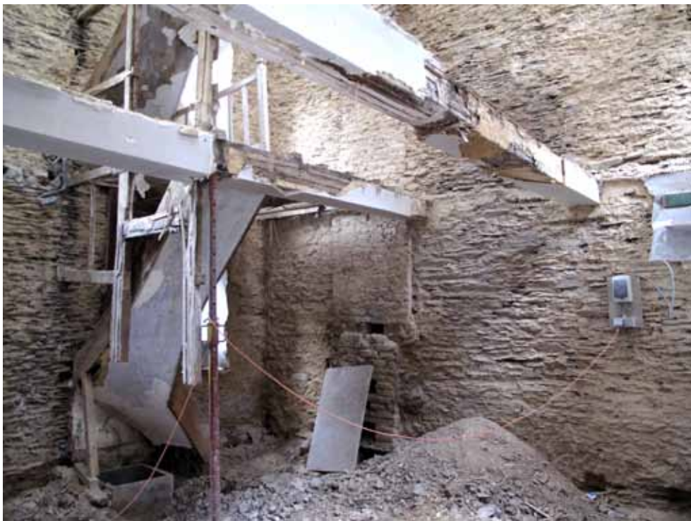
Habitation LAR, 2009. Démolition en cours de réalisation. Maçonnerie pierre de schiste © adn architectures
