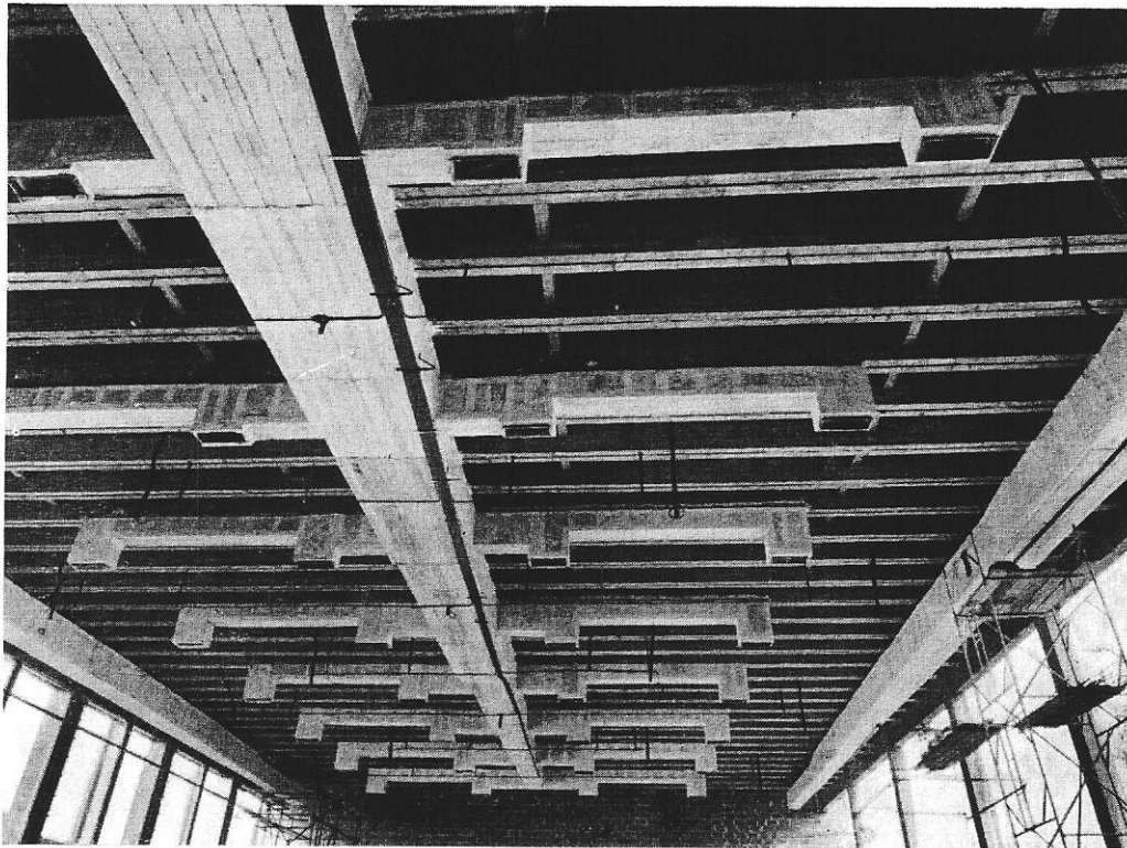
FIG. 3. — LES GAINES DE PULSION D'AIR CONDITIONNÉ au plafond de la salle des fêtes au centre, et de reprise d'air des deux côtés le long des fenêtres.
